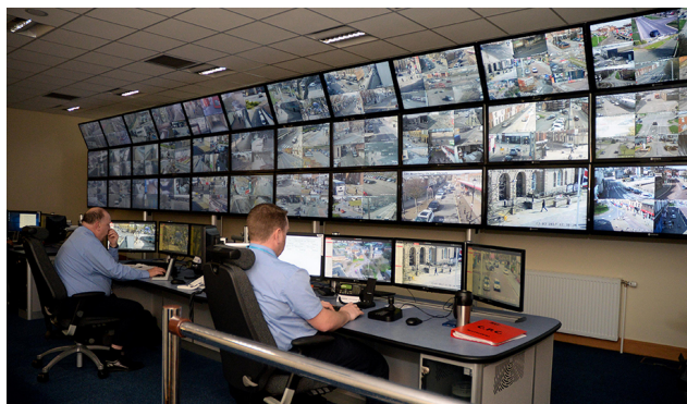
Obr. 2.4: Príklad kontrolnej miestnosti kamerových systémov (zdroj [58]).
