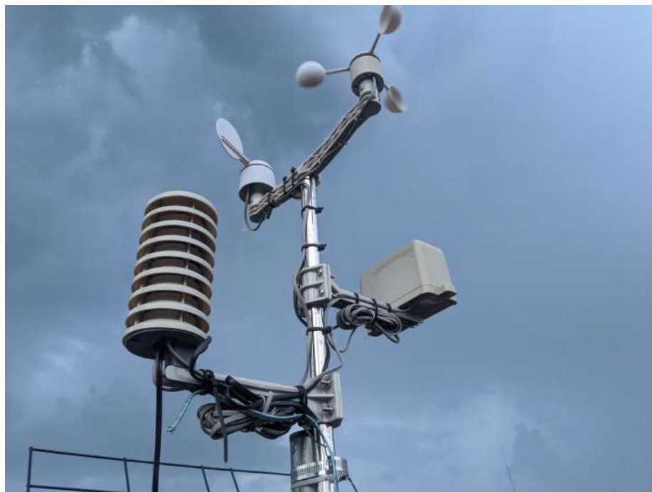
Obrázek 5.3: Meteostanice 2.0 na střeše.
