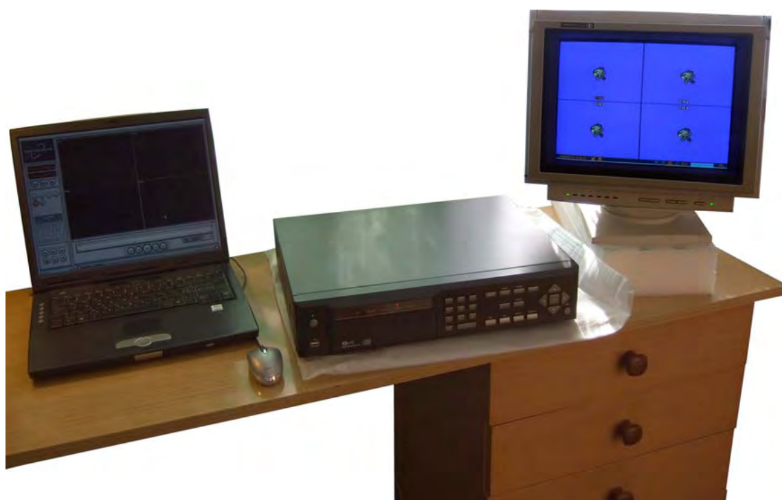
Obrázek A.7: Ukázka realizace kamerového systému
